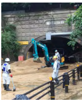
土砂で埋まったトンネル
